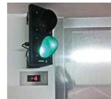
Détail des feux de circulation
